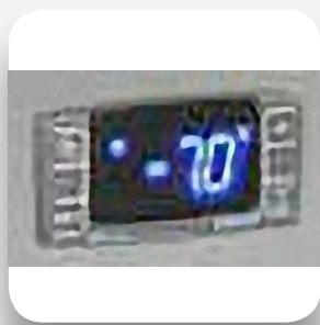
Control con alarma.
