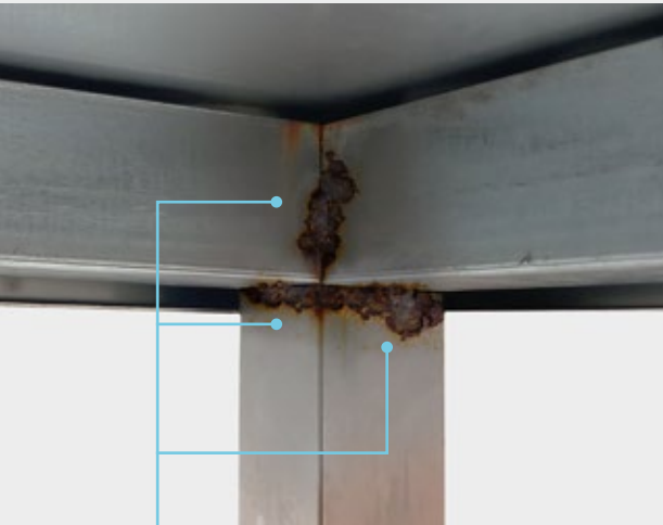
Oxidación por soldadura
