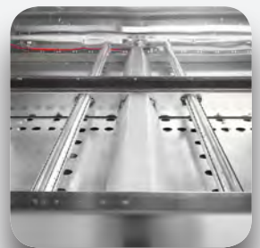
Quemadores con control electrónico de la llama.
